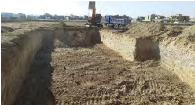
Préparation du site de la construction du Centre Médical Français de Sinjar par le contractant général irakien
